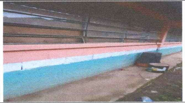
Foto 4: Se observa la necesidad de impermeabilizar la losa y las cunetas de concreto
