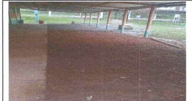
Foto 1: Se observa la necesidad de la torta de cemento dado que en época de lluvia se enloda. Y los canales pluviales dado que el agua se estanca por la inexistencia de cunetas.
