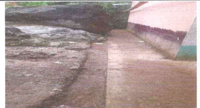
Foto 2: Se observa la necesidad de las cunetas de concreto, la impermeabilización de losa y las bajadas pluviales.
