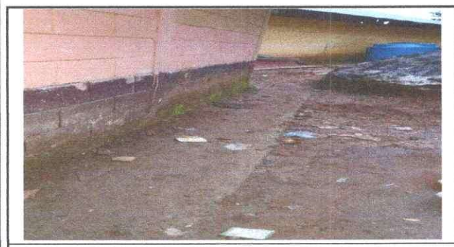
Foto 5: Se observa la necesidad de lavamanos
